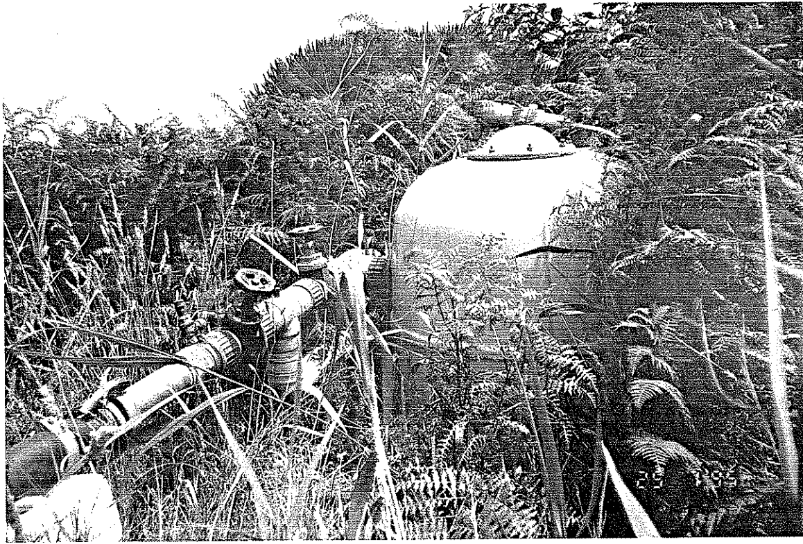
FIG.2.- Equipo de extracción de agua para uso agrícola en La Laguna de Las Madres (provincia de Huelva), Localidad nº 3.
